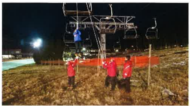
「国際トリプルリフト 4号支柱付近」
